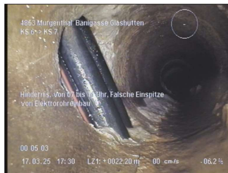
Foto: 12_8A, 00:05:02 22.2m, Hindernis, von 07 bis 11 Uhr / Falsche Einspitze evt. von Elektrorohr und Wasserleitungseinbau
