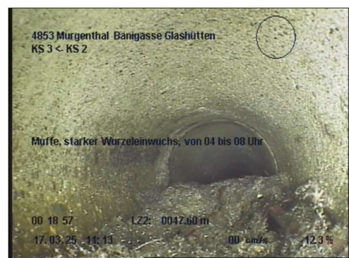
Foto: 2_27A, 00:18:56 47.6m, Muffe, starker Wurzeleinwuchs, von 04 bis 08 Uhr
