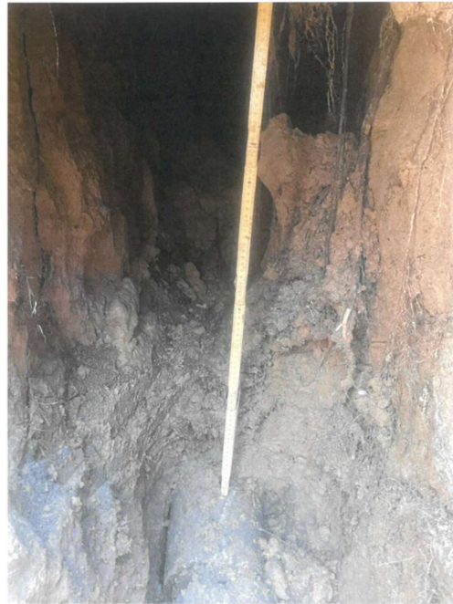
Abbildung 12 : Foto 1 Jablo, Unterspülte Leitung
