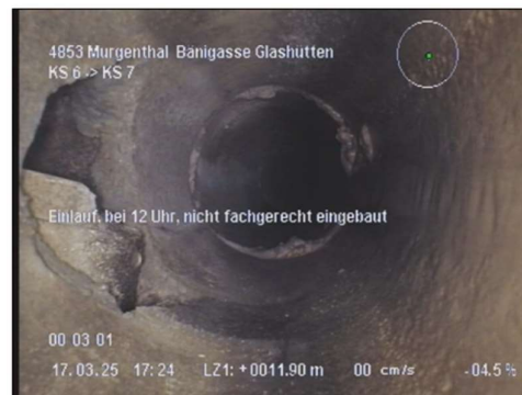
Foto: 12_7A, 00:03:01 11.9m, Einlauf, bei 12 Uhr, nicht fachgerecht eingebaut
