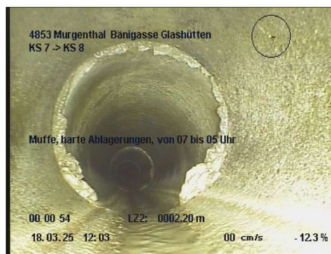
Foto: 14_5A, 00:00:53 2.2m, Muffe, harte Ablagerungen, von 07 bis 05 Uhr
