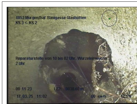
Foto: 2_18A, 00:11:21 38.6m, Reparaturstelle von 10 bis 02 Uhr / Wurzeleinwuchs 2 Uhr
